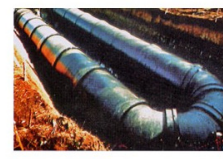
⑤五領調整場(S55.3完成) ・緊急貯水槽 V=370m 3 DIP φ 2,600・L=70m ・水圧調整設備
